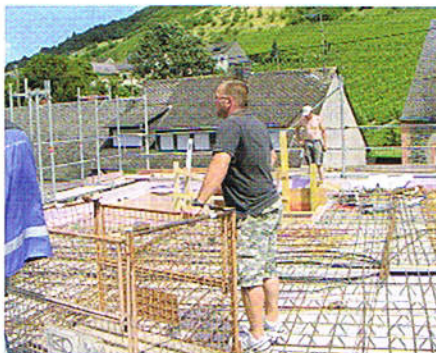
Der homogene Rohbau, die zukunftsichere Basis, des Hotelneubaus «Schlafgut» wurde in 3 1/2 Monaten fertig gestellt.
