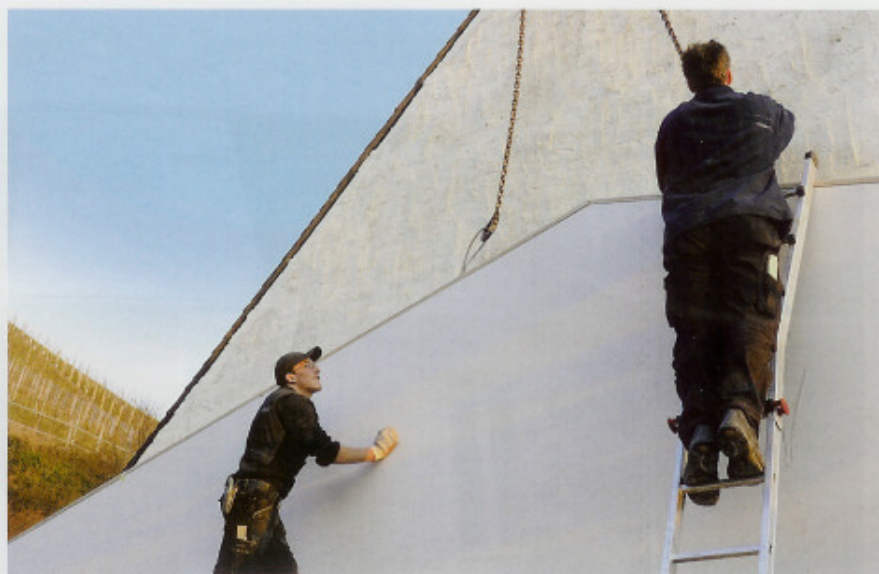
Statt einer Brandwand aus massiven Baustoffen erhielt das Gebäude eine Brandersatzwand in gekapselter Holzrahmenbauweise. Sie entspricht einer Feuerwiderstandsklasse von F 90 B.
