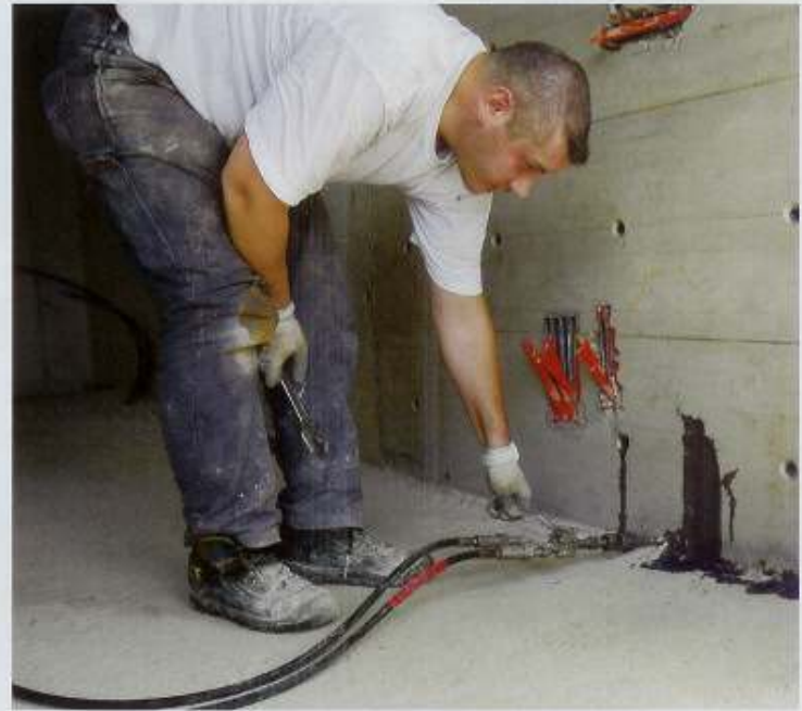
Während des Injektionsvorgangs hat das Harz die gleiche Viskosität wie Wasser und dringt bis zur Sättigung in den Beton ein
