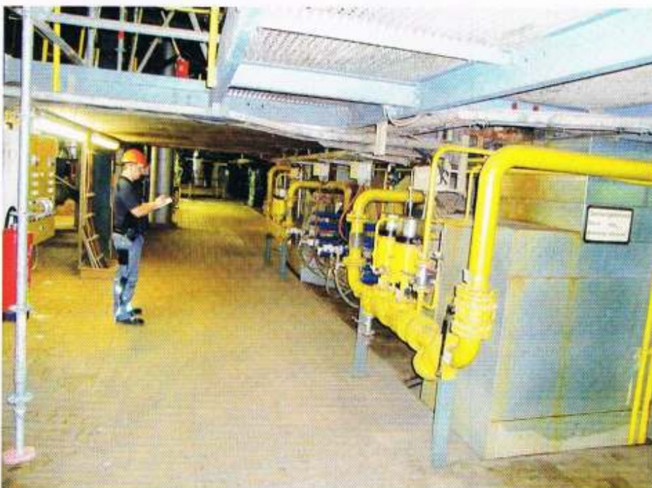
Sachkundiger der B.I.K. Anlagentechnik vor Ort bei der Anlagenaufnahme. Erfassungsbogen als Basis der elektronischen Archivierung. Bild: B. I. K. Anlagentechnik
